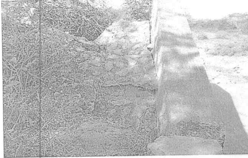
Foto N°1 Estructuras deterioradas en el PR 28+800 de la Vía Oriental.
